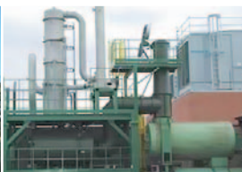
Nasswäscher Wet Scrubber
